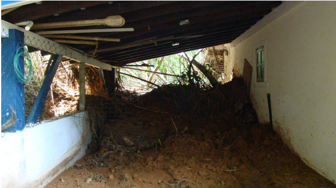
Foto 4: Residência atingida por escorregamento de pequeno porte Bairro Trindade.
