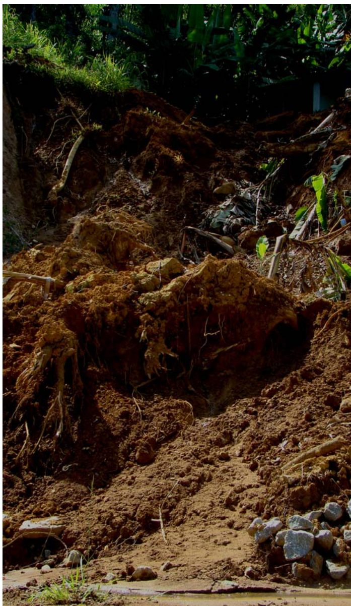
Foto 6: Escorregamento no km 584, Pedras Azuis.
